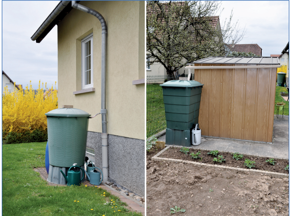
Récupérateurs d'eau de pluie
